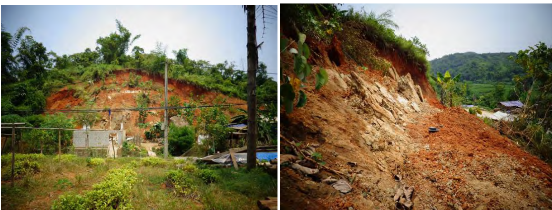
Hình 13: Nhà cửa bị phá hoại do khối trượt BK.030103.DB, xảy ra tại xã Địa Linh, huyện Ba Bể, tỉnh Bắc Kạn.
