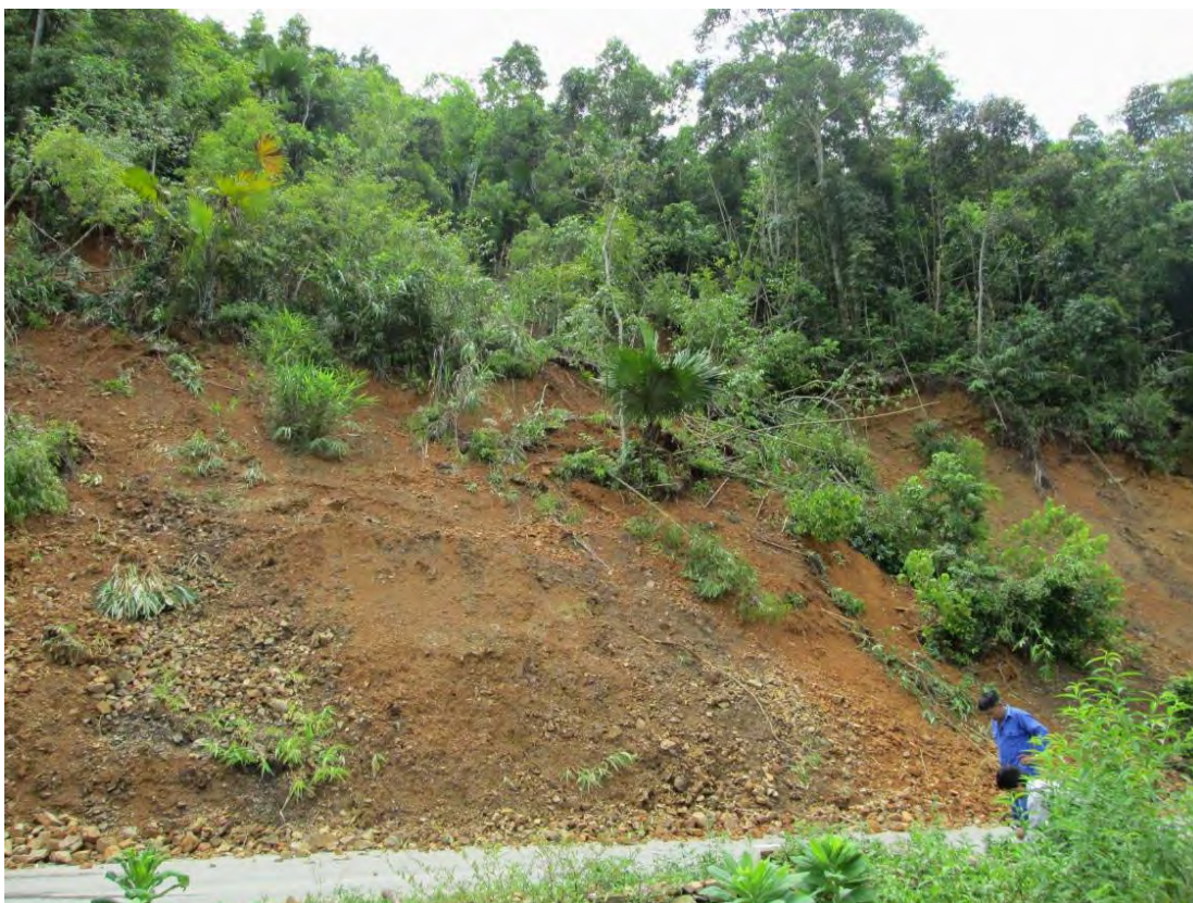
Hình 6: Trượt lở xảy ra ngay cả khi được che phủ rất tốt, tại ta luy đường 257 đoạn qua huyện Bạch Thông, tỉnh Bắc Kạn.
