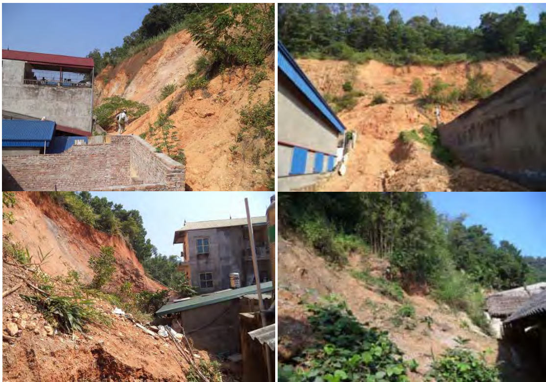
Hình 27: Một số hình ảnh về các khối trượt BK.070602ĐB, BK.070603ĐB tại khu vực Thị trấn Chợ Mới: người dân làm nhà sát taluy và không có công trình bảo vệ.
