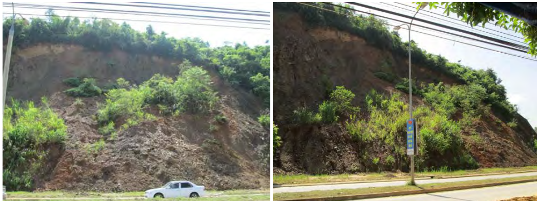
Hình 17: Một số hình ảnh về điểm trượt lở đất đá BK.013103.DB cạnh Quốc lộ 3 tại phường Đức Xuân, thị xã Bắc Kạn.
