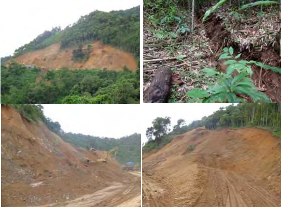
Hình 18: Khe nứt trên đỉnh khối trượt và toàn cảnh khối trượt BK.010109.DB xảy ra ở xã Phương Linh, huyện Bạch Thông. Công tác thi công khắc phục hậu quả tại khối trượt BK.010109.DB đã tiến hành 1 tháng.
