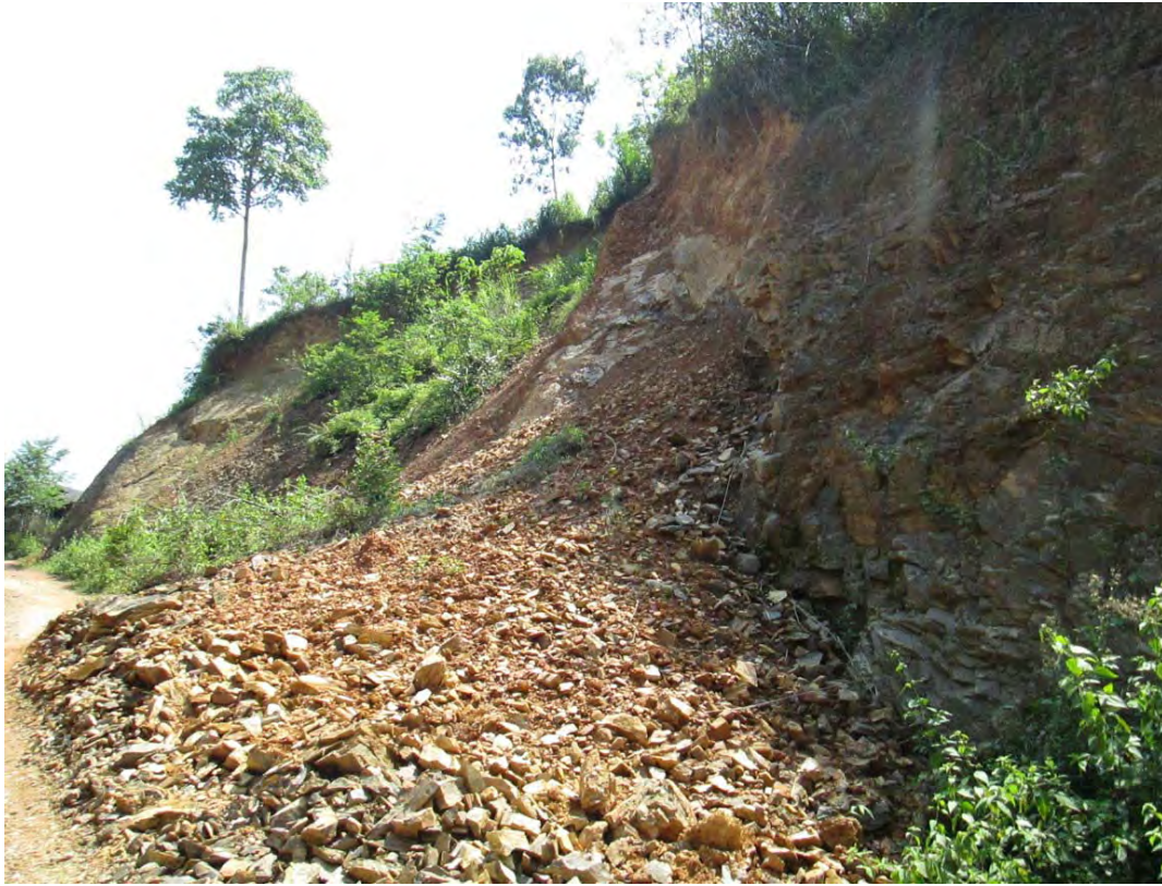
Hình 36: Đá cát kết bị đập vỡ mạnh gây đổ lở tại điểm BK.061407.ĐB, xã Xuân Dương, huyện Na Rì.
