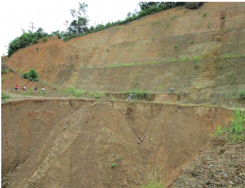
Hình 34: Một số hình ảnh về khối trượt BK.060502.DB xảy ra tại taluy âm do dùng vật liệu san lấp gia cố không có kè bảo vệ, thuộc địa phận xã Hảo Nghĩa, huyện Na Rì.
