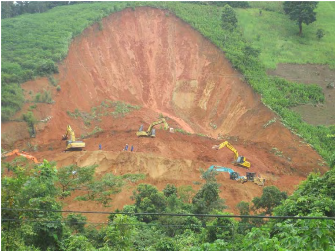
Hình 12: Điểm trượt DB.110004/1.VL trên vách taluy đường tại Km58+600 Quốc lộ 279 , đoạn đi qua xã Nà Nhạn, huyện Điện Biên, tỉnh Điện Biên. Trượt lở đất đá xảy ra ngày 26/08/2013 do mưa lớn kéo dài. Lượng đất đá phải giải phóng gần 180.000 m 3 gây ách tắc giao thông trong 5 ngày. Vỏ phong hóa dày gần 30 m trên nền đá xâm nhập Granodiorit , thành phần chủ yếu là sét, bột, cát và mảnh vụn đá.
