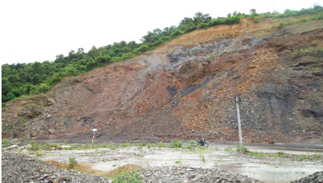
Hình 23: Nguy cơ trượt lở đất đá từ vách ta luy đường Quốc lộ 12 (điểm khảo sát ĐB.210008.VL), hướng Mường Chà vào Thị xã Mường Lay, đe dọa cơ sở hạ tầng và giao thông trên tuyến đường. Khu vực này đã xảy ra trượt lở đất đá trong các mùa mưa 2012 và 2013
