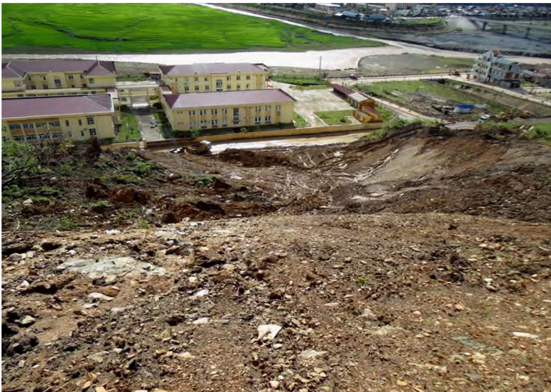
Hình 24: Nguy cơ trượt lở đất đá từ vách ta luy đường Quốc lộ 12 (điểm khảo sát ĐB.210010.VL), đối diện với bệnh viện Thị xã Mường Lay, đe dọa tới công trình bệnh viện mới được xây dựng.
