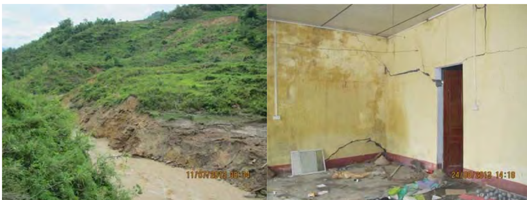
Hình 30: Sụt lún đất gây sập đổ nhà dân tại thôn Tân Sơn, xã Nám Dẩn, huyện Xín Mần.
