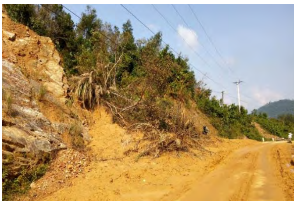
Hình 30: Vật liệu tràn xuống đường gây cản trở giao thông
