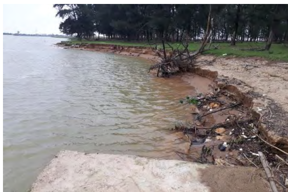
Hình 45: Xói lở dọc sông Lam do quá trình khai thác cát trái phép tại thôn Hồng Lam, xã Xuân Giang.
