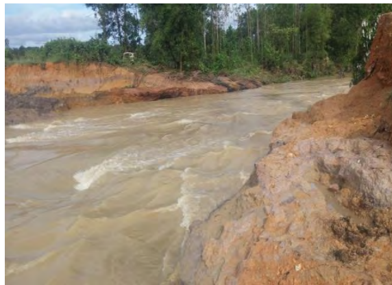
Hình 31: Thân đập bị vỡ làm lượng nước đổ ra hạ lưu lớn
