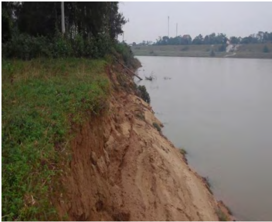
Hình 80: Cầu tạo đường bờ trầm tích bờ rời Độ Túr dễ gây xói lở bờ sông
