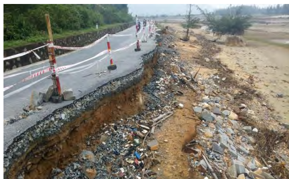
Hình 42: Xói lở bờ biển dọc vách taluy âm đường TL.547
