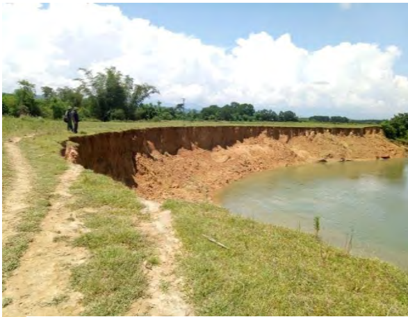
Hình 16: Xói lở bờ sông tại xóm 3, xã Hương Đô
