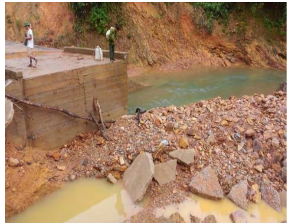
Hình 19: Lũ quét thôn Thuận Trị, xã Hương Vĩnh tháng 9 năm 2017 làm hư hỏng hoàn toàn 1 nhịp cầu bê tông gây ách tắc giao thông.
