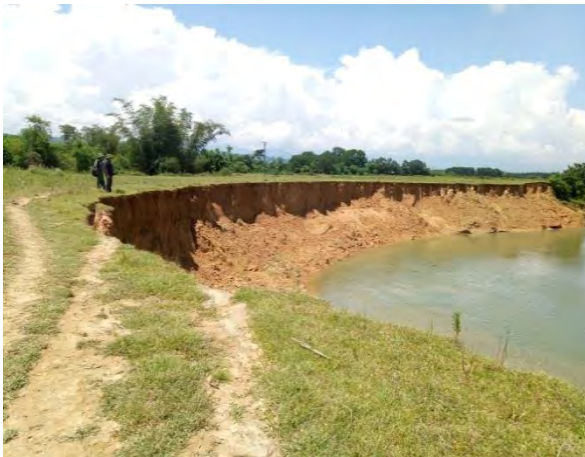
Hình 8: Xói lở bờ sông tại xóm 3, xã Hương Đô
