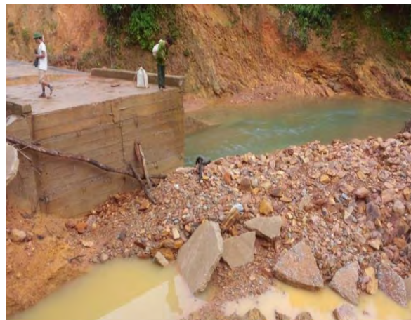
Hình 3: Lũ quét thôn Thuận Trị, xã Hương Vĩnh tháng 9 năm 2017 làm hư hỏng hoàn toàn 1 nhịp cầu bê tông gây ách tắc giao thông.
