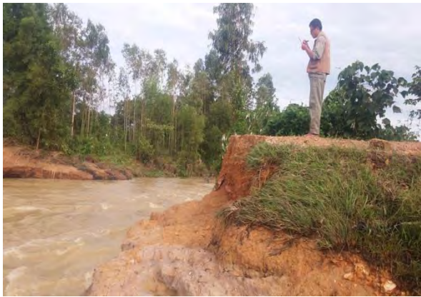
Hình 32: Đập Chính đập Cồ Châu, xã Gia Hanh bị vỡ
