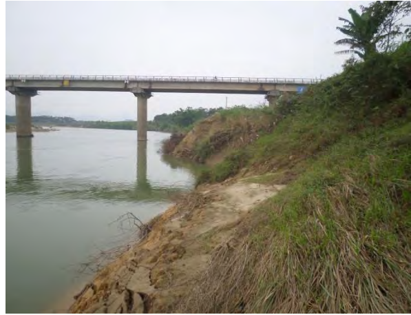
Hình 87: Cầu Ngàn Phố, xã Sơn Trung nguy cơ xói lở ăn sâu vào móng chân cầu, gây nguy hiểm
