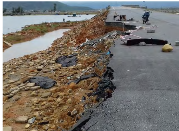
Hình 139: Điểm xói lở tại đường trục ngang thôn Tân Thắng, xã Kỳ Ninh
