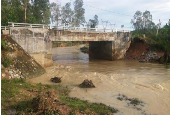
Hình 34: Đập vỡ gây sạt lở mố cầu Cá Gáy
