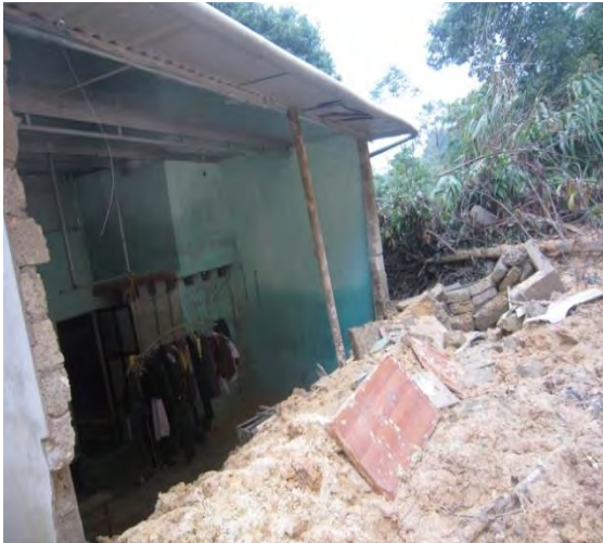
Hình 97: Vật liệu khối trượt đã vùi lấp toàn bộ công trình phụ và làm sập bờ tường sau nhà ở
