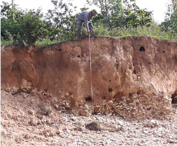
Hình 137: Xói lở bờ sông Trú thôn Hoa Tiến, xã Kỳ Hoa
