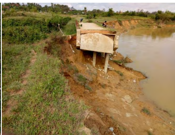
Hình 18: Xói lở bờ sông làm hư hỏng nặng cầu và đường tại xóm 1, xã Gia Phú
