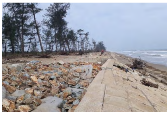
Hình 41: Xói lở đê biển tại thôn Bình Phúc, xã Xuân Đan, huyện Nghi Xuân
