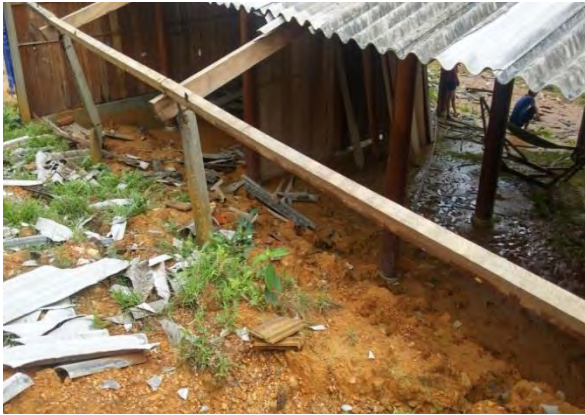
Hình 28: Vật liệu khối trượt tràn vào nhà sập hoàn toàn nhà bếp, vùi lấp đồ đạc
