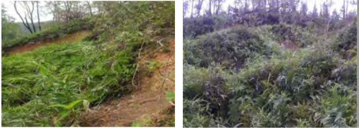
Hình 107: Khối trượt tại thôn Hoa Thám, xã Cẩm Lạc
