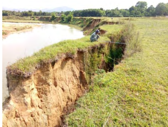
Hình 15: Xói lở bờ sông tại xóm 5, xã Hương Đô
