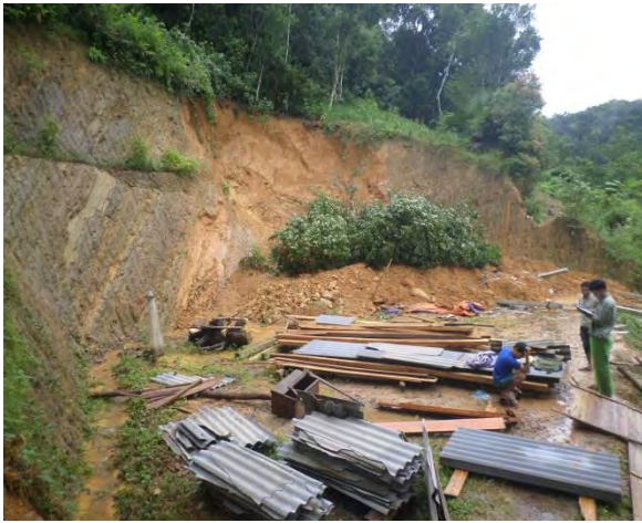
Hình 94: Khối trượt lở xảy ra vào đêm 10/10/2017 tại thôn 10, xã Sơn Lĩnh đã gây sập đổ toàn bộ nhà dân
