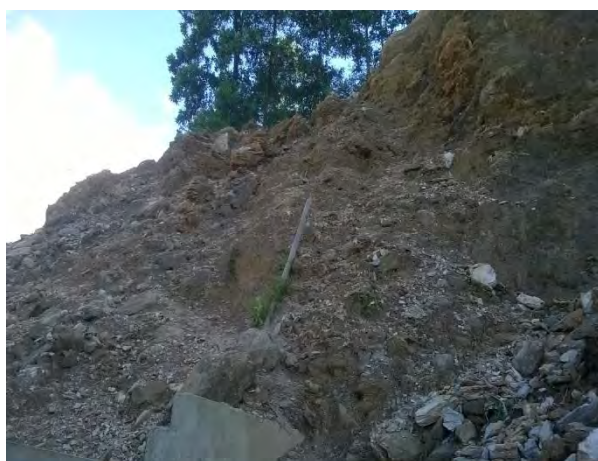
Hình 69: : Trượt lở trong đá phiến sét, hệ tầng La Khê, tại thôn 1, Hương Thọ làm sập 1 đoạn bờ tường.
