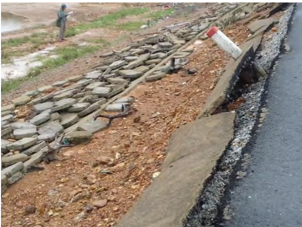
Hình 140: Điểm xói lở tại đường trục ngang thôn Quyền Hành, phường Kỳ Trinh
