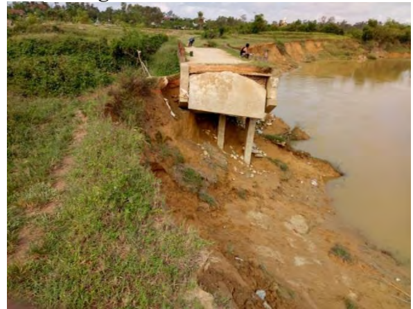
Hình 5: Xói lở bờ sông làm hư hỏng nặng cầu và đường tại xóm 1, xã Gia Phố
