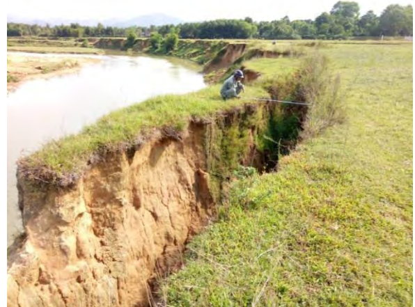
Hình 6: Xói lở bờ sông tại xóm 5, xã Hương Đô
