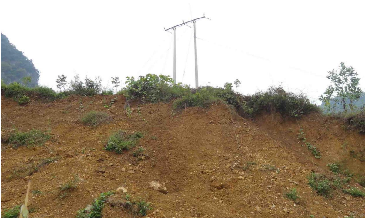
Hình 47. Trượt lở gây nguy hiểm cho mạng lưới truyền tải điện tại khu vực xóm Rọi, xã Quý Hòa, huyện Lạc Sơn.
