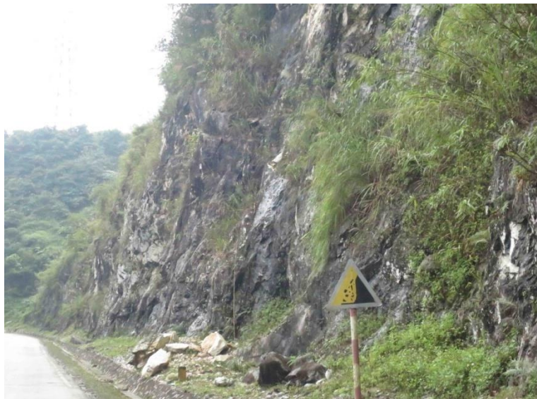
Hình 38. Điểm đá đổ, rơi thuộc khu vực xã Thung Khe, huyện Mai Châu, gây nguy hiểm cho giao thông.
