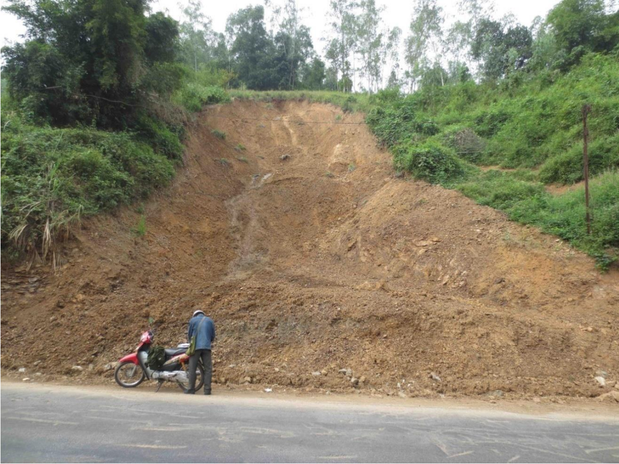
Hình 22. Điểm trượt lở trên Quốc lộ 6, gây nguy hiểm cho giao thông tại Thành phố Hòa Bình
