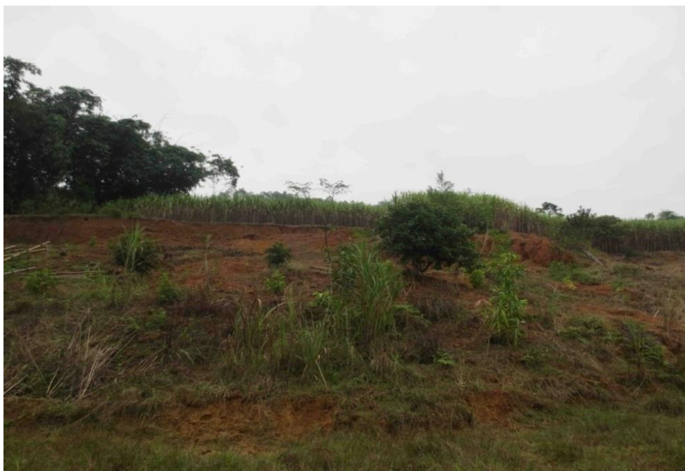
Hình 28. Trượt lở đe dọa nhà dân tại khu vực xóm Ong 2, xã Nam Phong, huyện Cao Phong
