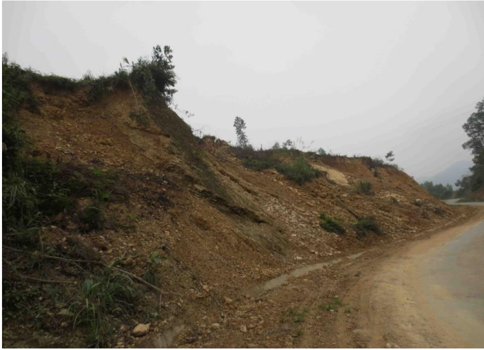
Hình 34. Điểm trượt tại khu vực xã Dân Hòa, huyện Kỳ Sơn, gây nguy hiểm cho giao thông của người dân
