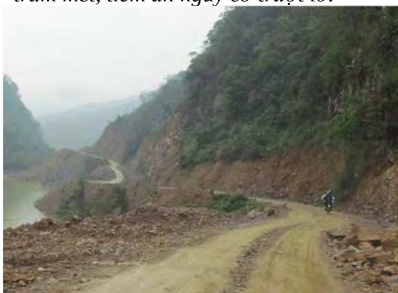
Hình 18: QL 12 đoạn qua xã Pa Tần tạo vách taluy cao, tiềm ẩn nguy cơ trượt lở, xói lở bờ sông.
