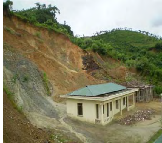
Do san nền nhà trên đới đá đập vỡ phong hóa mạnh của đứt gãy, toàn bộ khu nhà vừa xây xong đã bỏ hoang.
