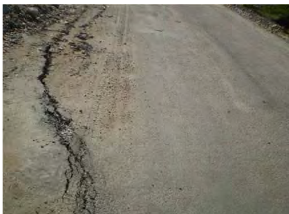
Mặt đường bị rạn nứt nghiêm trọng dài >200m.
