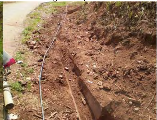
Vết nứt làm bung mương nước và rạn nứt cắt qua đường.
