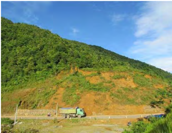
Quang cảnh khối trượt ở vách taluy đường đã làm sập cả bờ kè đường.
