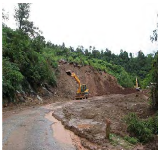
Máy xúc đang dọn đất đá trượt xuống đường giao thông.
