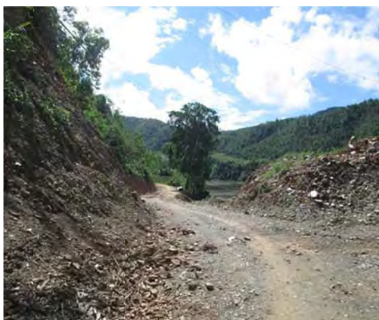
Hình 29. Khối trượt nằm trong đèo phá hủy, cà nát đập vỡ mạnh gây hỏng nặng toàn bộ đoạn đường dài 200m.
