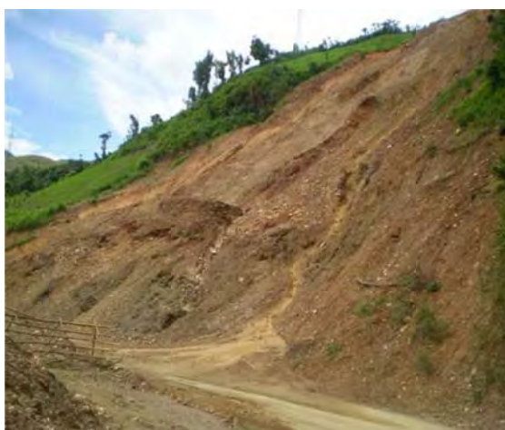
Khối trượt tràn xuống đường và có nguy cơ phá hỏng đường.
