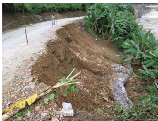
Hình 62. Điểm xói lở sâu vào đường TL132 gây mất an toàn giao thông.
