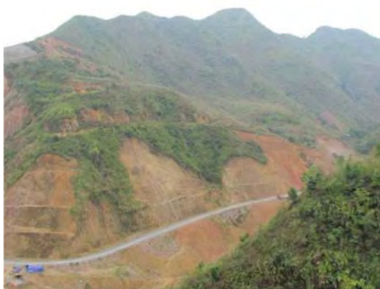
Hình 16: Xây dựng QL279 đoạn qua thủy điện Bản Chát tạo vách taluy cao hàng trăm mét, tiềm ẩn nguy cơ trượt lở.
