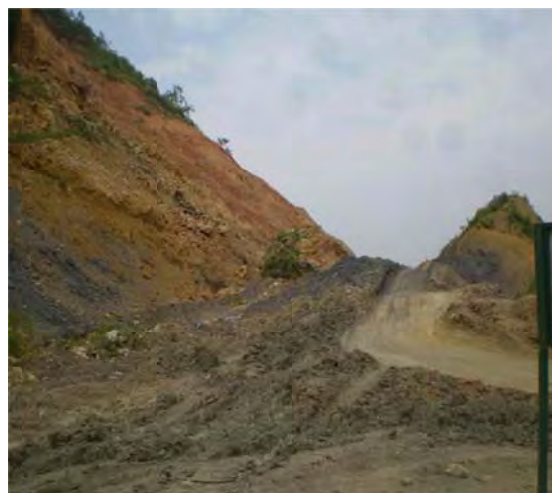
Đoạn đường phần dưới chân khối trượt bị hư hỏng nặng.
