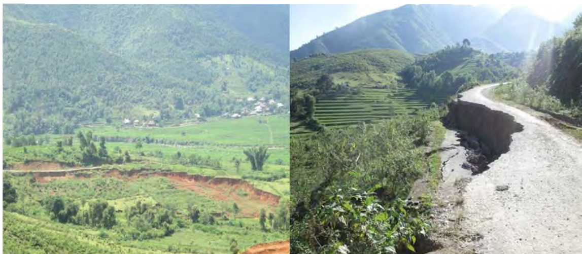
Hiện trạng toàn bộ khối trượt vách taluy âm đường liên thôn thuộc chân sườn núi cao.
