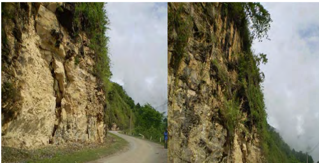
Hình 58. Một số hình ảnh trượt lở tại điểm nguy cơ đá đổ đá rơi (LC.007195.L4): Vết nứt kéo dài theo vách taluy đường TL128 km 12 khu vực đèo Làng Mô.
