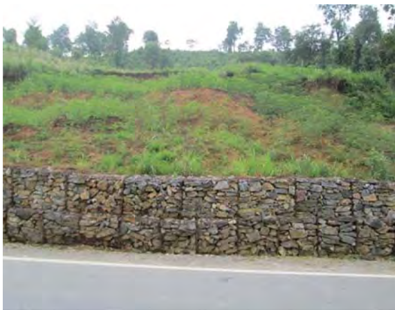
Khối trượt đã được khắc phục kè rọ đá, nhưng vẫn còn nguy cơ trượt.
