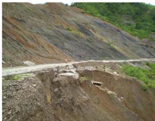
Phần taluy âm đường bị sạt lở có nguy cơ hỏng đường.
