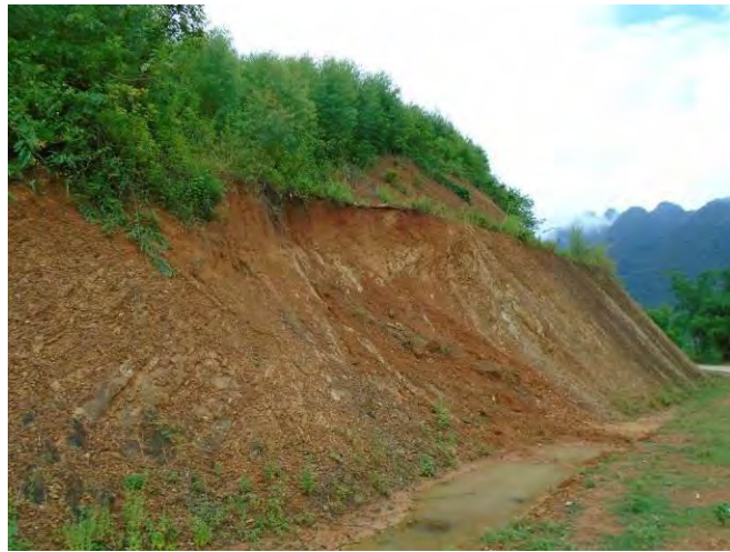
Hình 66. Khối trượt LS.005433.KS thuộc xã Hòa Lạc, huyện Hữu Lũng, với thành phần đất đá bị phong hóa nứt nẻ, dập vỡ, sản phẩm chủ yếu là cát, sét, bột.
