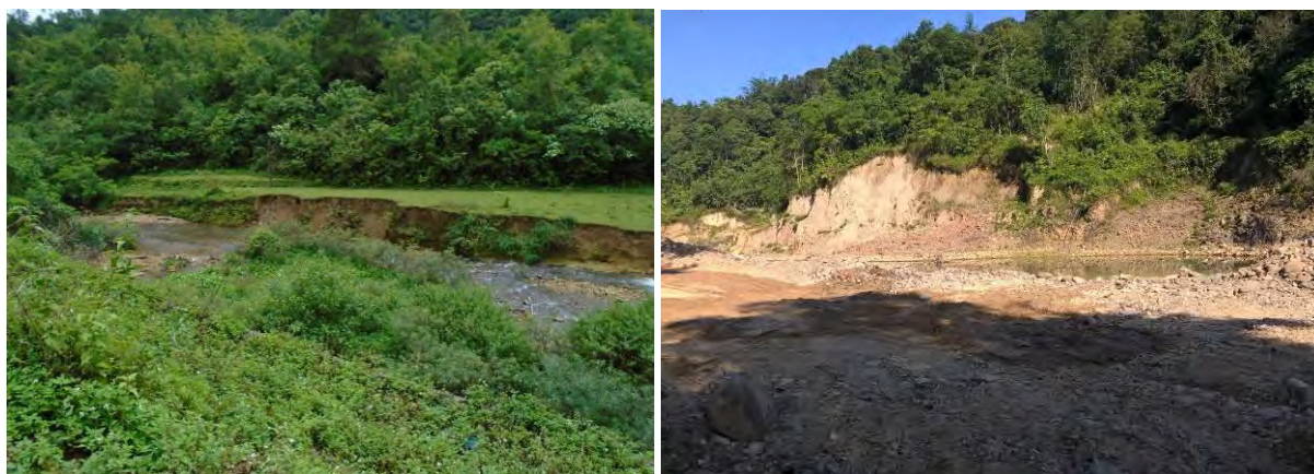
Hình 18. Một số vị trí xảy ra xói lở bờ sông, suối trên địa bàn tỉnh Lạng Sơn: tại thôn Khòn Coong, Tú Xuyên, Văn Quan (hình trái) và tại thôn Sông Cháy, Hồng Việt, Tràng Định, Lạng Sơn (hình phải).
