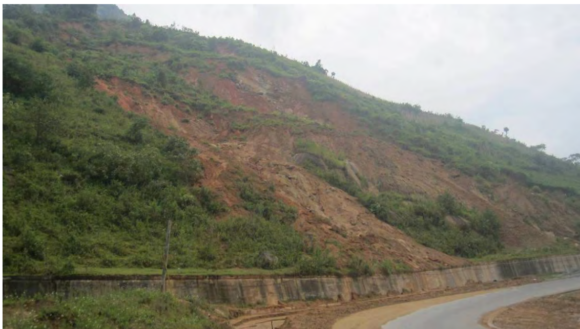
Hình 58. Toàn cảnh khối trượt tại Cầu Mống Sến, trên quốc lộ 4D thuộc địa bàn huyện Sa Pa
