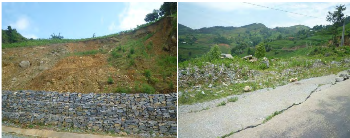
Hình 48. Trượt lở đất đá trên tuyến tỉnh lộ 153 đi qua thôn Lử Chồ 1, xã Lầu Thí Ngài, huyện Bắc Hà gây sụt lún và ách tắc giao thông, và có nguy cơ tiếp tục xảy ra trượt lở đất đá.
