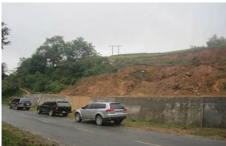
Hình 74. Nguy cơ trượt lở đất đá từ các taluy dọc tuyến quốc lộ 4D thuộc địa phận thôn Giàng Tra, xã Sa Pả, huyện Sa Pa ảnh hưởng đến đường dây điện và trường học.
