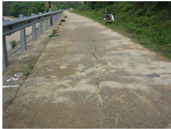
b. Xói lở bờ sông làm nứt đường tại xã Kim Sơn, huyện Bảo Yên
