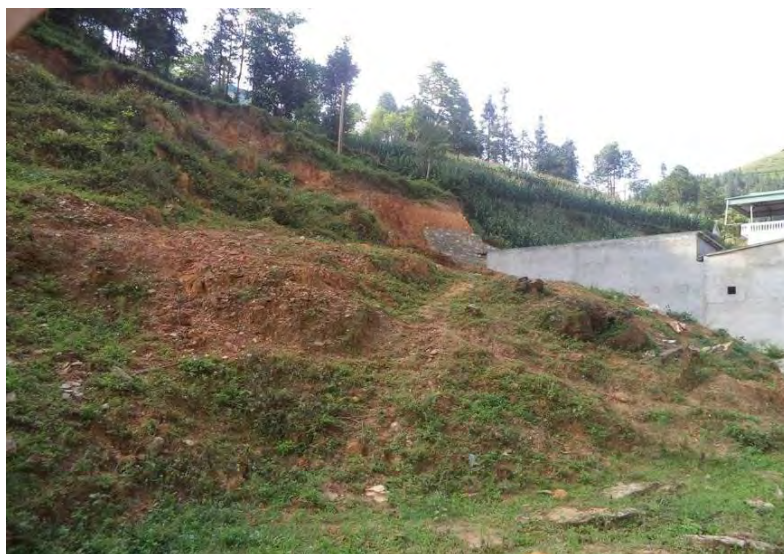
Hình 71. Khối trượt tại thôn Rì Thành 1, xã Na Hối, huyện Bắc Hà gây ảnh hưởng đến nhà dân và nguy cơ tiếp tục trượt.
