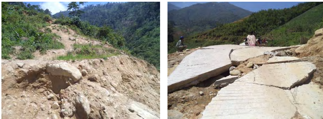
Hình 54: Trượt lở đất đá tại thôn Phìn Hồ Thầu, xã Tả Phời phá hủy đường bê tông liên bản.
