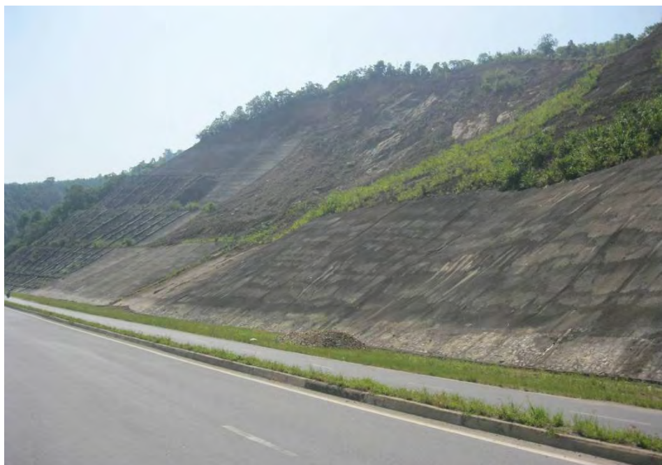
Hình 73. Vách taluy trên tuyến quốc lộ 70, thuộc địa phận tổ dân phố 10, phường Lào Cai, Thành phố Lào Cai có thể xảy ra trượt lở với quy mô trung bình.
