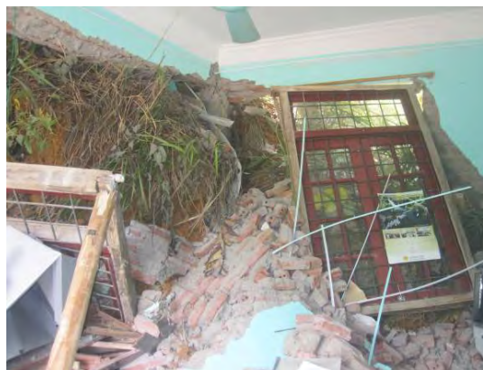
Tường nhà và đồ đạc trong nhà bị phá hủy
