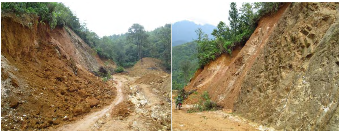
Hình 61. Trượt lở đất đá tại thôn Dền Thành, xã Tả Van gây ách tắc giao thông.
