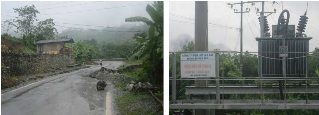
Hình 31. Trượt lở đất đá tại thôn 9, xã Thượng Hà, huyện Bảo Yên làm hỏng mất đường Quốc lộ 70, tiếp tục có dấu hiệu trượt, sạt taluy âm và đe dọa sự an toàn của trạm biến thế điện, giao thông và nhà dân.
