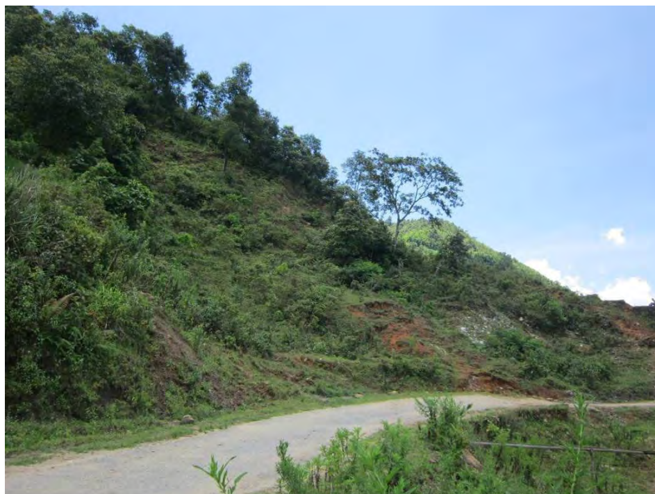
Hình 72. Khối trượt tại thôn Trung Chải, xã Dền Sáng, huyện Bát Xát cơ nguy cơ tiếp tục xảy ra, ảnh hưởng giao thông
