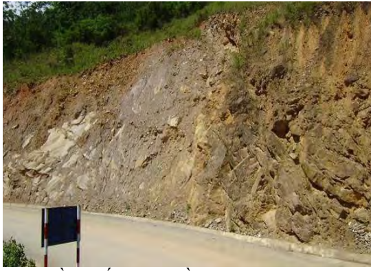
Một phần khối trượt Cầu Tám: dọc vách taluy QL7 là đất đá cát bột kết bị nứt nẻ mạnh, phần trên phong hóa trung bình - mạnh, dày 2-5 m.
