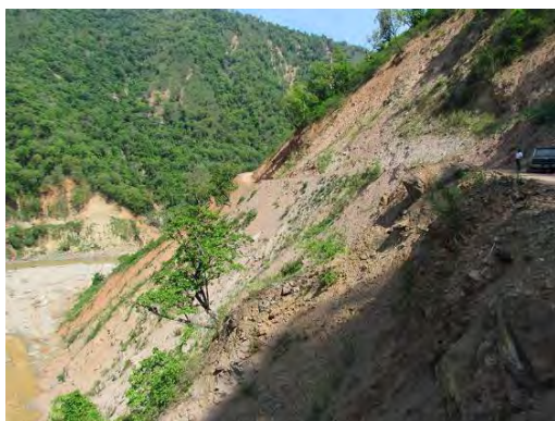
Hình 20: Trượt chảy và đổ lở dọc vách taluy đường Mường Típ - Mường Xén, huyện Kỳ Sơn.
