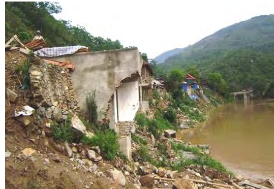
Xói lở bờ sông ở vách taluy âm Quốc lộ 7 gây sập nhà dân.
