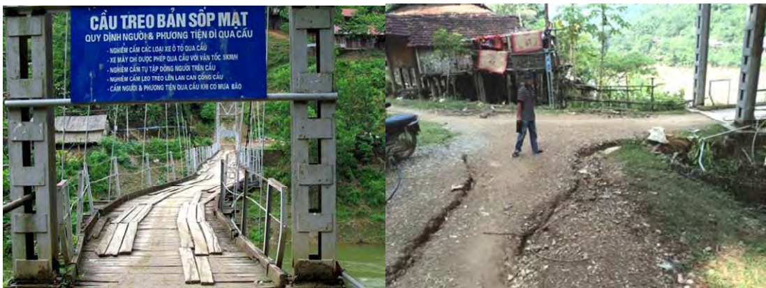
Hình 31. Trượt lở đất đá làm phát sinh các khe nứt dọc bờ sông, đẩy cầu treo Sốp Mạt uốn cong hình chữ “S”.
