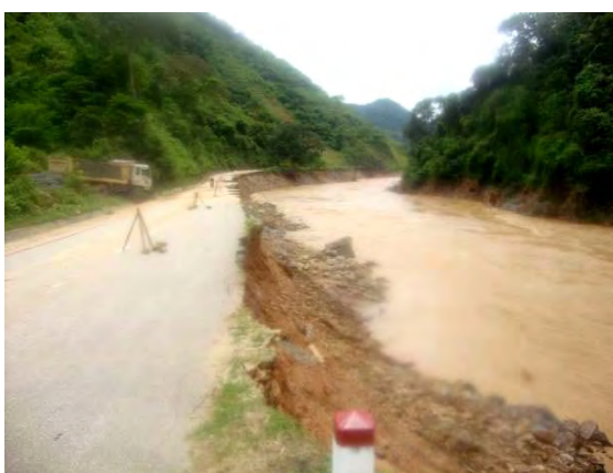
Hình 9: Xói lở bờ sông gây sạt lở nghiêm trọng Quốc lộ đoạn thuộc địa phận bản Bà, xã Hữu Kiệm, huyện Kỳ Sơn.
