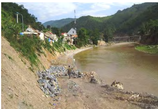
Hình 7: Xói lở bờ sông đoạn thuộc địa phận thị trấn Mường Xén, huyện Kỳ Sơn.
