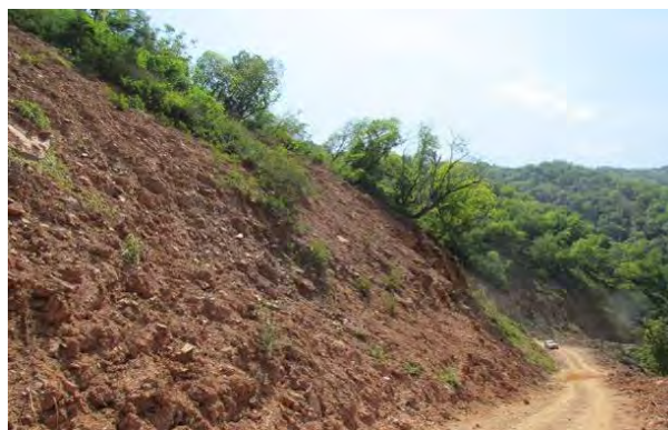
Hình 21: Đá bột kết phong hóa mạnh trên vách taluy dốc 40-50°, bị trượt khi gặp mưa lớn.
