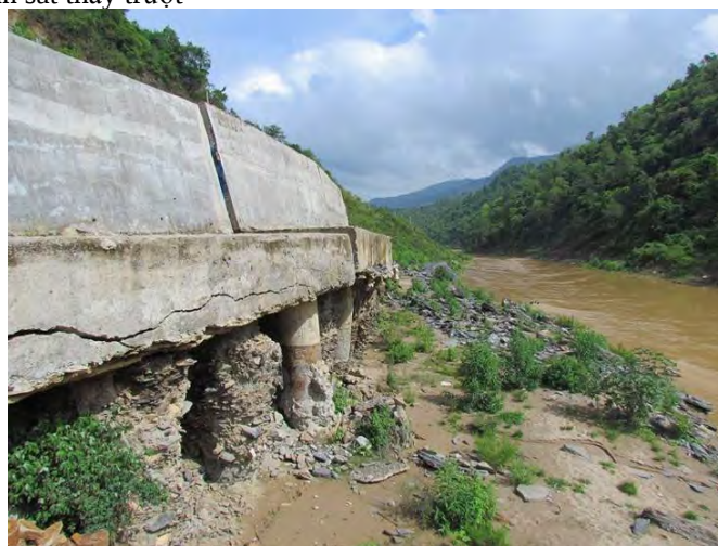
Kè chắn tại chân khối trượt bị nứt vỡ và dịch chuyển về phía sông
