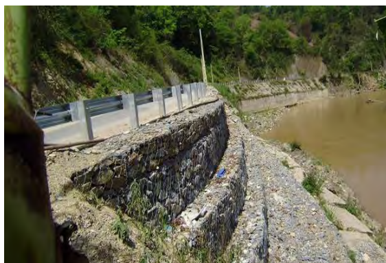
Hình 8: Kè rọ đá chống xói lở bờ sông, bảo vệ Quốc lộ 7 đoạn thuộc địa phận bản Khe Nằn, xã Chiêu Lưu, huyện Kỳ Sơn.
