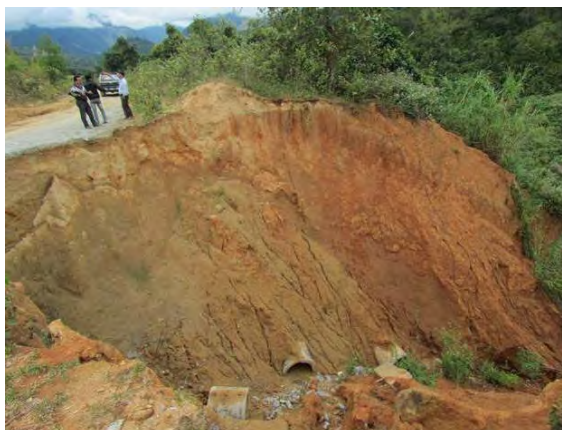
Hình 23: Trượt lở vách taluy âm gây sạt nền đường ô tô đoạn thuộc địa phận Na Ngoi - Mường Ải, nam huyện Kỳ Sơn.
