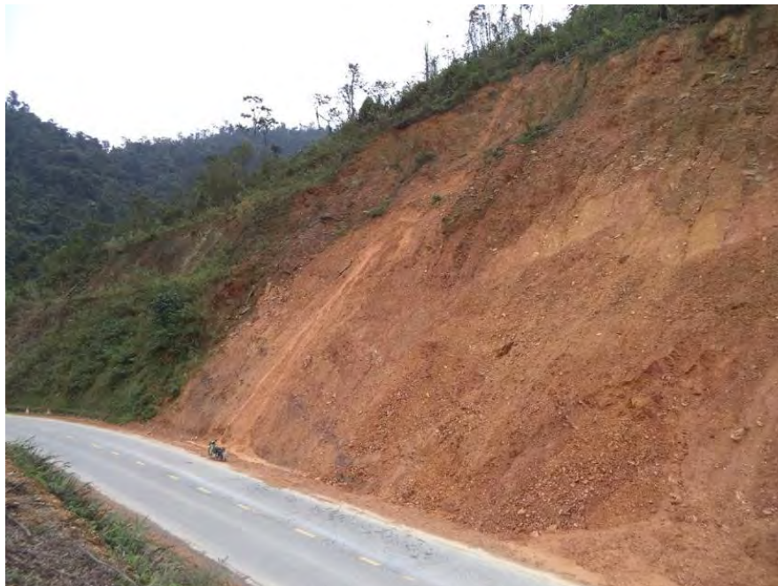
Hình 60. Biện pháp bạt thoải mái dốc địa hình, giạt cấp taluy tại khối trượt QB.058814.TB, xảy ra tại sườn taluy ven quốc lộ 12C, thuộc thôn Bà Tâm, xã Thuận Hóa, huyện Tuyên Hóa.
