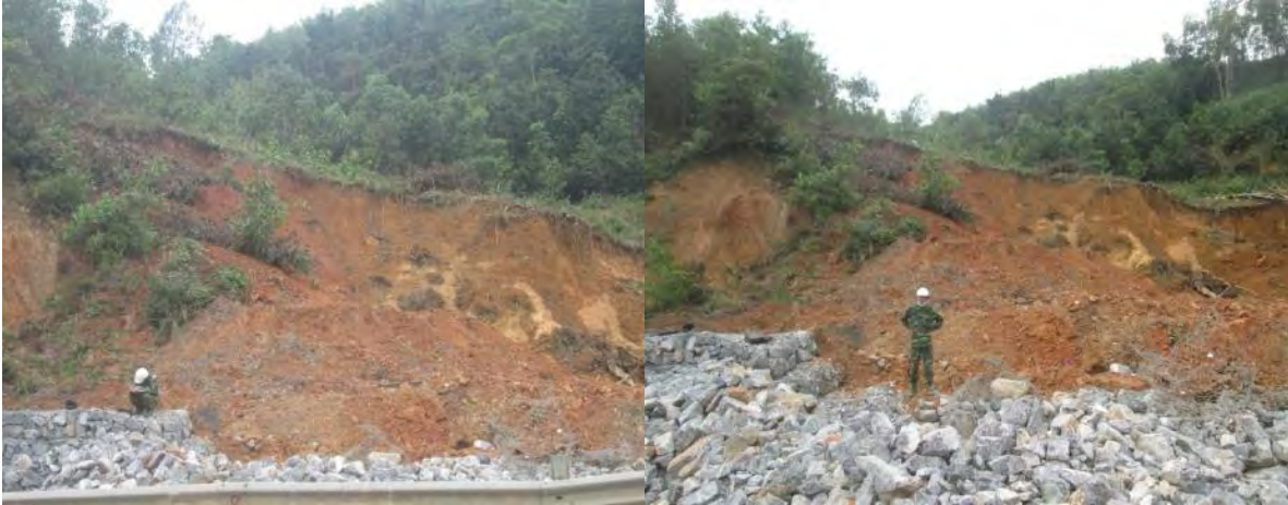
Hình 58. Cắt xẻ taluy để xây dựng đường giao thông tăng nguy cơ trượt lở trên các vách taluy dương tại thôn Quảng Hóa, xã Hồng Hóa, huyện Minh Hóa, tỉnh Quảng Bình.
