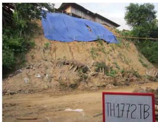
Khối trượt tại khu vực thôn Mau xã Mường Lý, huyện Mường Lát
