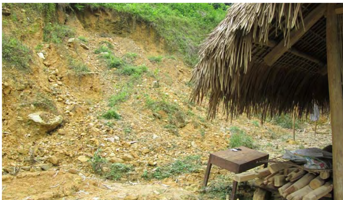
Hình 17: Nguy cơ TLDD từ vách taluy đe dọa vùi lấp nhà dân tại thôn Pắc Cáp, xã Minh Dân
