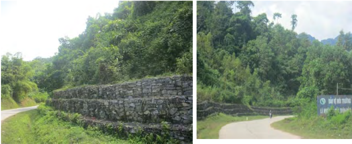
Hình 22. TLĐĐ tại bản Cốc Túm, thị trấn Vĩnh Yên, huyện Na Hang làm ách tắc giao thông và lún nứt Quốc lộ 279.
