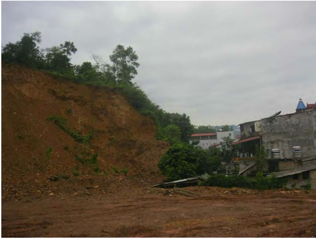
Hình 26. TLĐĐ đe dọa nhà dân tại tổ 12, thị trấn Vĩnh Yên, huyện Na Hang
