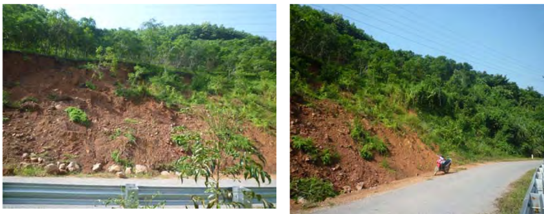
Hình 9. Đường liên xã tại thôn Gốc Trám, xã Kiên Đài bị đe dọa nếu tiếp tục xảy ra TLDD.
