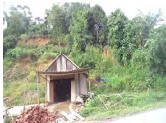
Trượt lở taluy làm hư hỏng nhà dân tại Khu phố I, xã Đồng Khê. Số hiệu YB.220423.L2 Ảnh: Nguyễn Văn Phú
