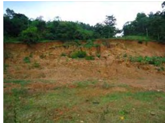
Trượt lở taluy sau nhà chị Hà Thu Hải, thuộc khu dân cư tại thôn Bến Đền, xã Đông Cường. Số hiệu YB.130185.L2.
