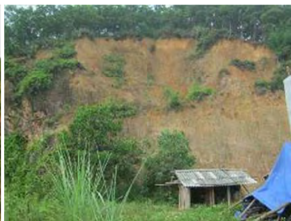
Trượt lở taluy, thuộc khu dân cư sau nhà anh Lương Công Nam tại thôn 5, TT Yên Bình. Số hiệu YB.110004.L2.
