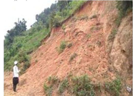
Điểm trượt lở tại taluy đường thuộc khu vực dân cư tại thôn Vũng Tàu, xã Hát Lù.
