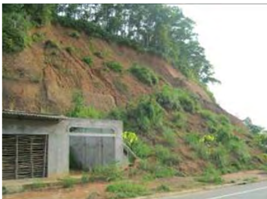
Kiểu trượt hỗn hợp, quy mô lớn gây hư hỏng nhà của dân tại thôn 3, xã Tân Thịnh
