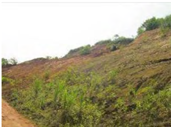
Trượt lở taluy ảnh hưởng tới đường giao thông tại thôn 5, xã Đại Sơn. Số hiệu YB.160165.L2
