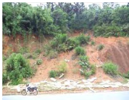
Kiểu trượt tịnh tiến, quy mô lớn tại thôn 8, xã Khánh Hòa
