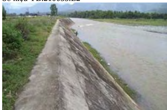
Điểm đã từng xảy ra lũ quét đã được bê tông hóa bờ. Số hiệu YB.270061.L2
