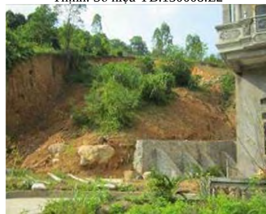
Trượt lở taluy ảnh hưởng đến nhà dân tại thôn Vực Tròn, xã Lương Thịnh. Số hiệu YB.120028.L2
