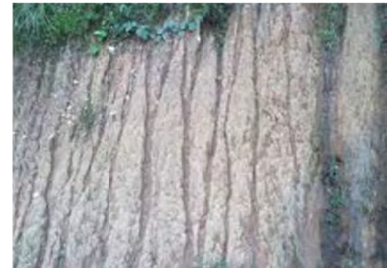
Rãnh xói trên vách taluy đường Tỉnh lộ 133 tại KM14+17, xã Trạm Tàu
