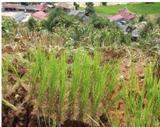
Trượt lở taluy âm làm nứt đường Quốc lộ 32, tại bản Dề Thành, xã Chế Cu Nha
