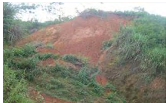
Trượt lở taluy làm hư hỏng, tắc đường phải mở đường mới tại thôn Ba Khuy, xã Nà Hâu. Số hiệu YB.160194.L2
