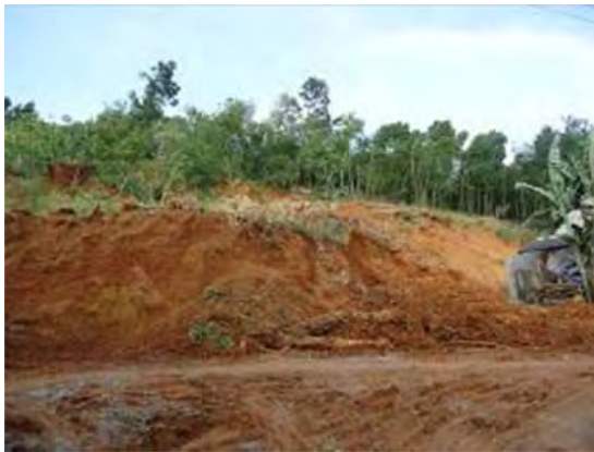
Trượt lở taluy sau nhà anh Bùi Văn Chung, thuộc khu dân cư tại thôn Làng Chẹo, xã An Thịnh. Số hiệu YB.130237.L2.
