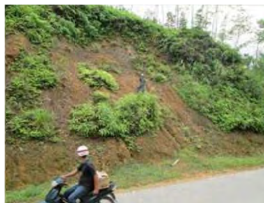
Trượt lở taluy, thuộc khu dân cư tại thôn 3, xã Việt Cường
