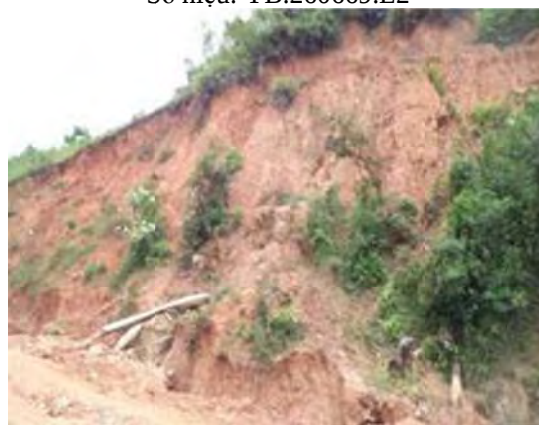
Trượt lở sườn núi gây ách tắc, hư hỏng đường giao thông tại thôn Lù 2, xã Hát Lù. Ảnh: Đặng Công Xê
