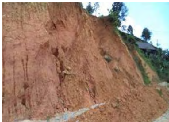
Trượt lở trên sườn ta-luy, thuộc khu dân cư, tại thôn Tĩnh Hưng, xã Hưng Khánh.
