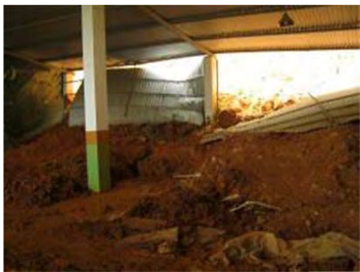
Trượt lở taluy làm hư hỏng nặng nhà xưởng, máy móc của Công ty CP An Lộc Phát tại thôn Đẳng Thọ, xã Phú Thịnh. Số hiệu YB.110026.L2. Ảnh: Đinh Công Hùng
