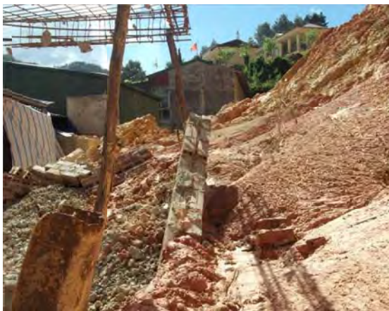
Điểm trượt lở taluy làm sập nhà dân tại bản Ngã Ba Kim, xã Púng Luông
