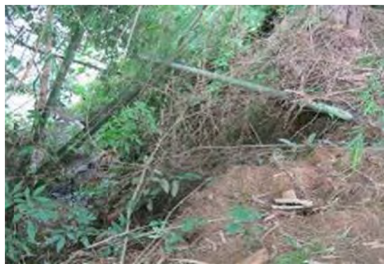
Điểm xói lở bờ sông tại thôn Yên Trung, xã Yên Phú. Số hiệu YB.160046.L2
