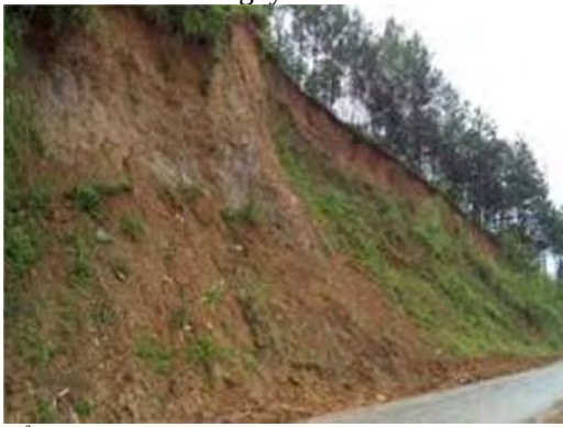
Điểm trượt lở tại sườn núi, ảnh hưởng đường tại thôn Điệp Quang, xã Phúc Sơn. Số hiệu YB.260821.L2. Ảnh: Võ Nguyên Thiện
