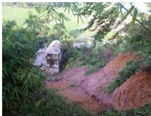
Trượt lở taluy ảnh hưởng đến nhà dân tại thôn Tân Lập, xã Hán Đà. Số hiệu YB.110137.L2. Ảnh: Đinh Công Hùng
