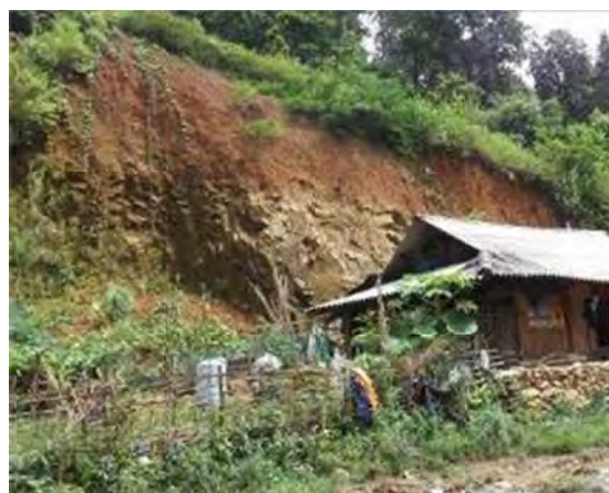
Điểm xẻ taluy làm nhà cửa cạnh đường Quốc lộ 32 - tại bản , xã Hồ Bốn
