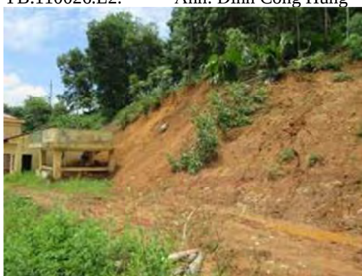
Trượt lở taluy làm hư hỏng nhà tại thôn 4, xã Đại Đồng. Số hiệu YB.140135.L2
