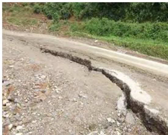
Khối nứt lớn tại sườn núi, phía trên nhà dân tại tổ 1, thị trấn Mù Cang Chải.
